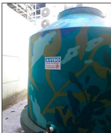
Figura 3A: Caixa de reúso de águas pluviais
